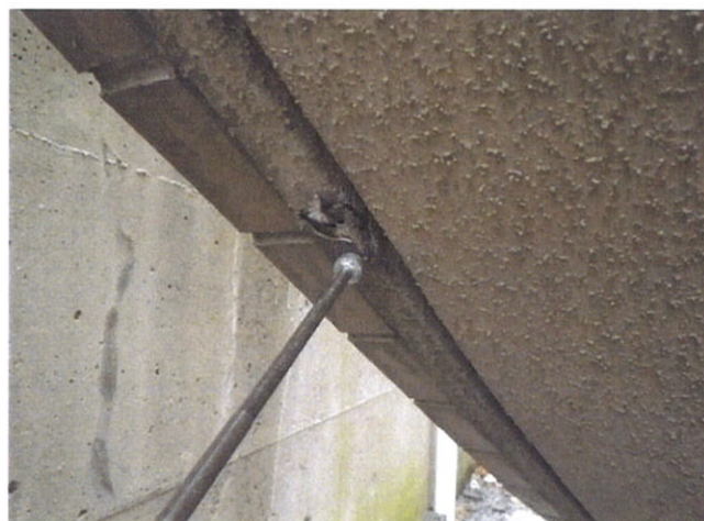
外部階段 上裏:爆裂
