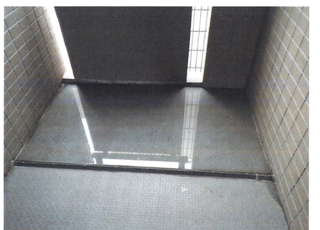
共用廊下 床面:滞留水
