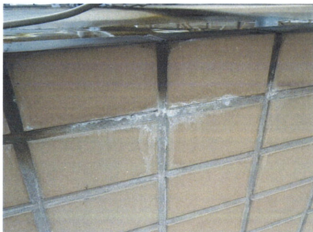
屋上 外壁:エフロレッセンス
