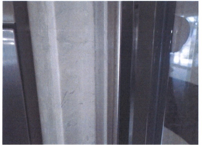
部 位: エントランス扉廻り目地 状 況: 汚れ
