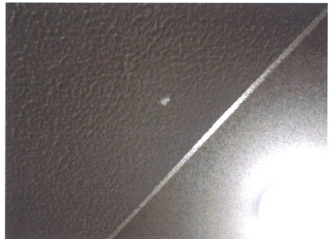
共用廊下 梁下:塗膜剥離
