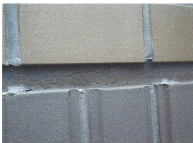
部 位：打継目地 状 況：ひび割れ
