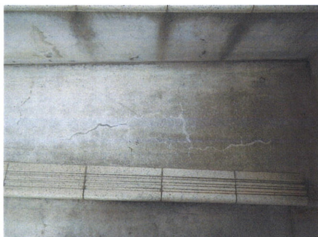
外部階段 踏面：亀甲ひび割れ
