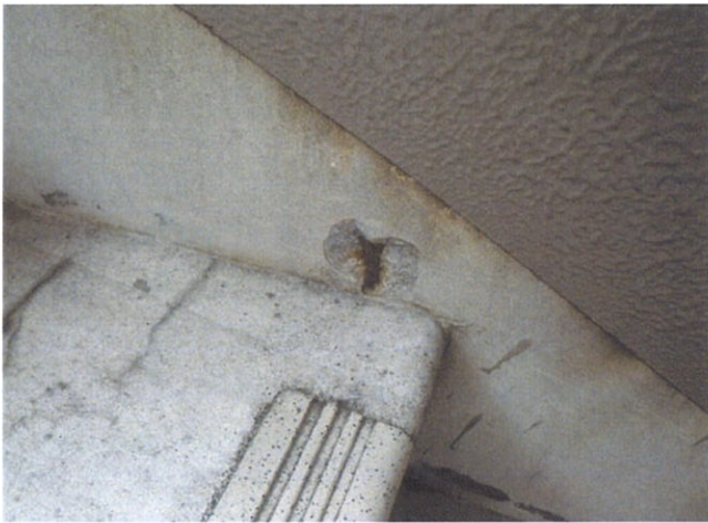
外部階段 巾木:鉄筋爆裂
