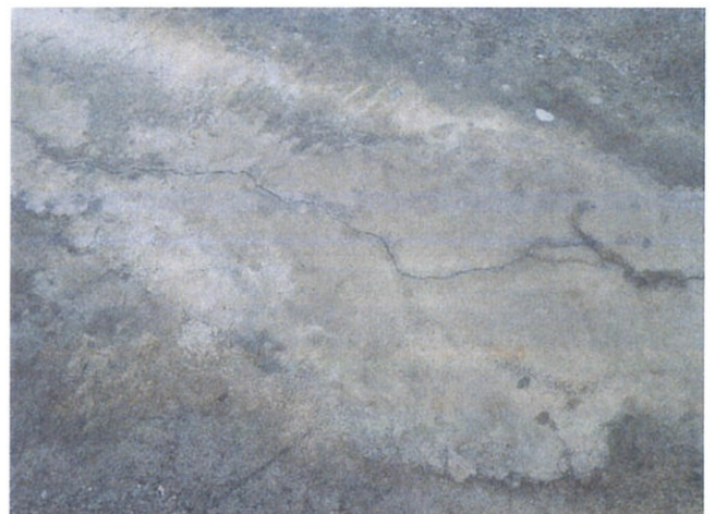
屋上 平場:ひび割れ
