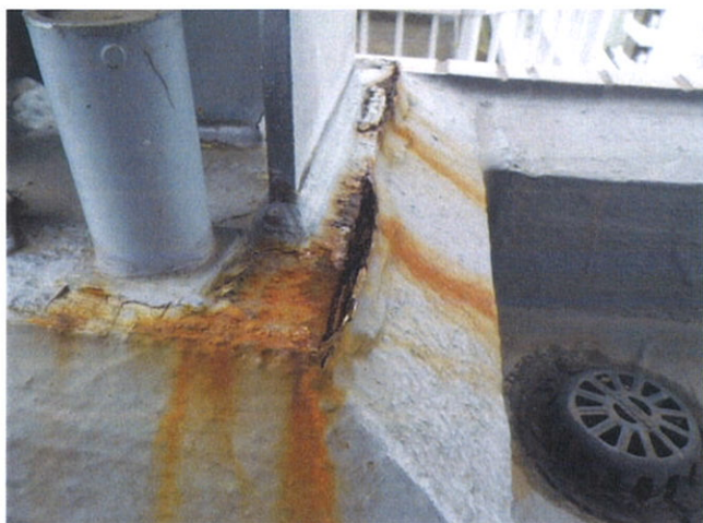
架台：塗膜剥離・錆汁の析出
