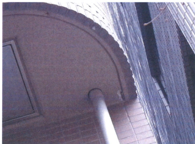
バルコニー 上裏:鉄筋爆裂
