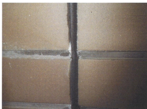
部 位：タイル目地 状 況：汚れ
