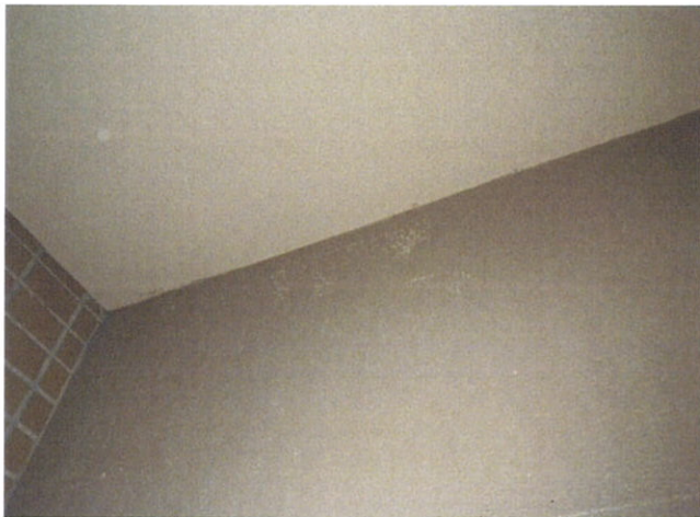
共用廊下 内壁:経年による汚れ
