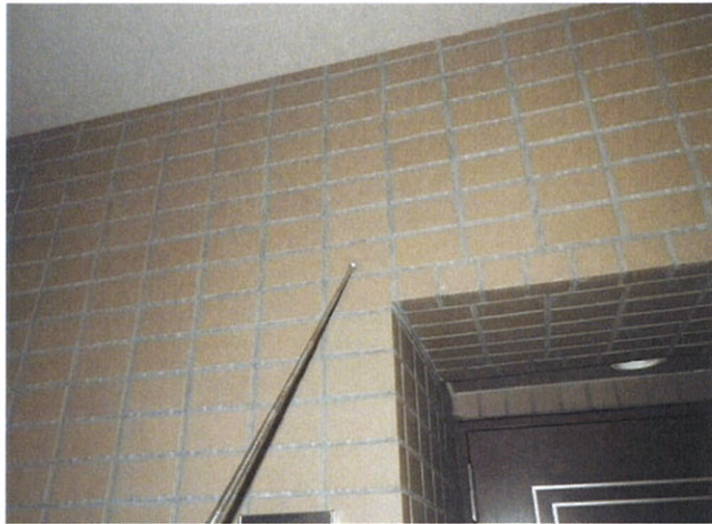
共用廊下 内壁:タイルの浮き
