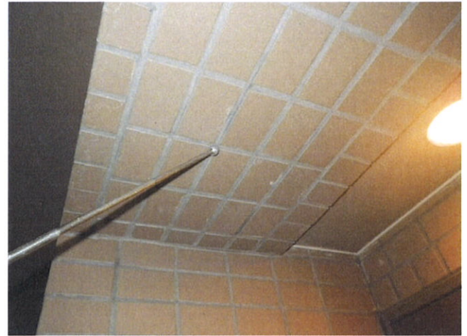
共用廊下 梁下:タイルの浮き
