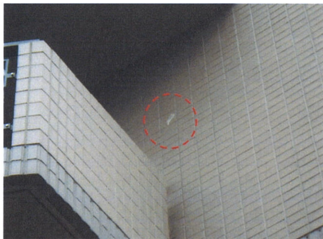
外壁:エフロレッセンス
