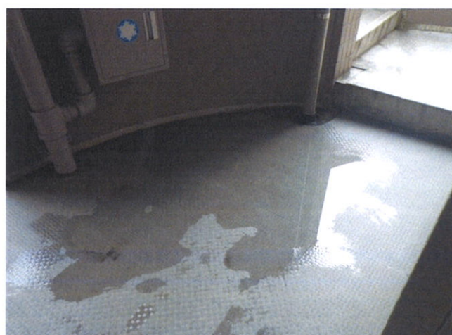
共用廊下 床面：滞留水
