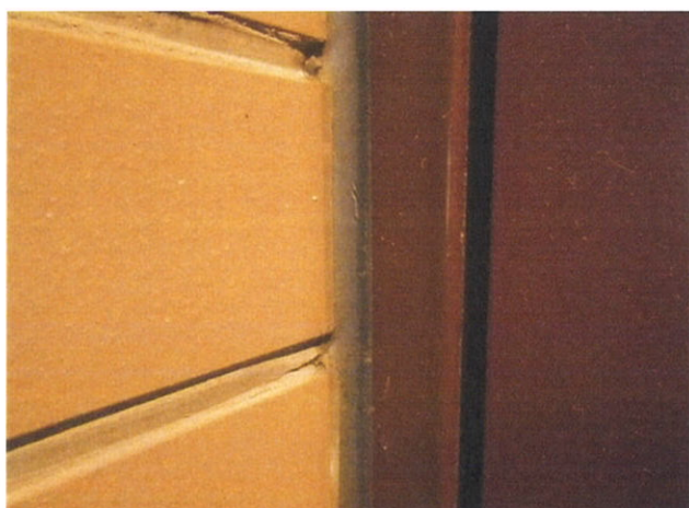
部 位：玄関扉廻り目地 状 況：汚れ
