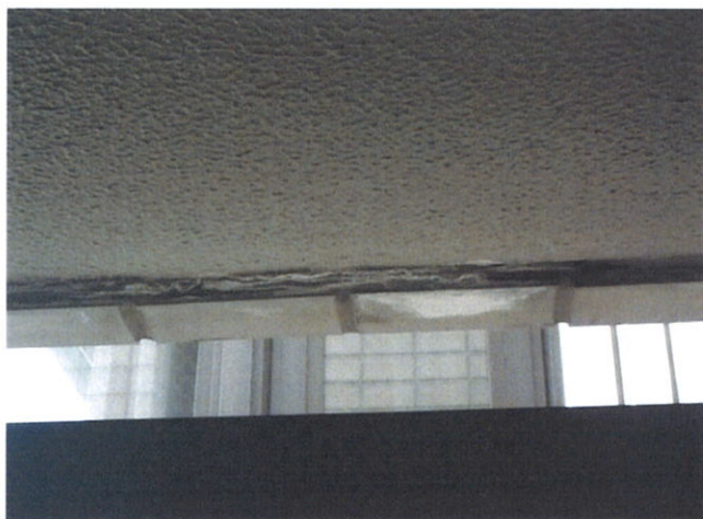
共用廊下 上裏:エフロレッセンス
