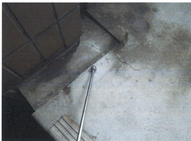
外部階段 踊場：モルタルの浮き
