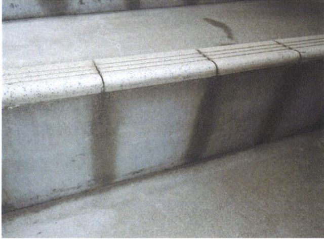
外部階段 蹴上:雨染み汚れ
