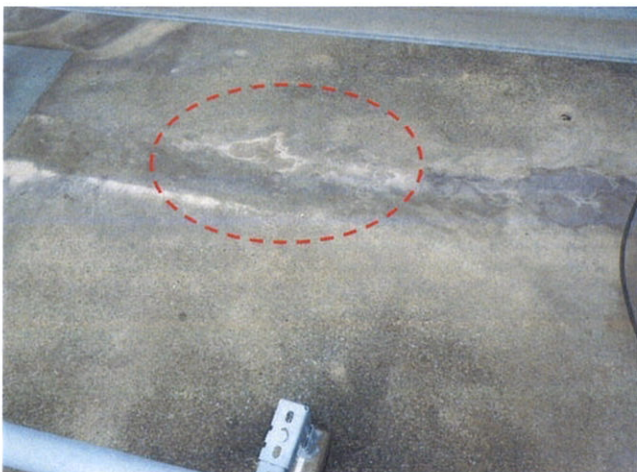
屋上 平場:エフロレッセンス
