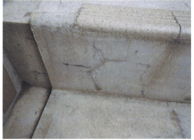
外部階段 蹴上:亀甲ひび割れ
