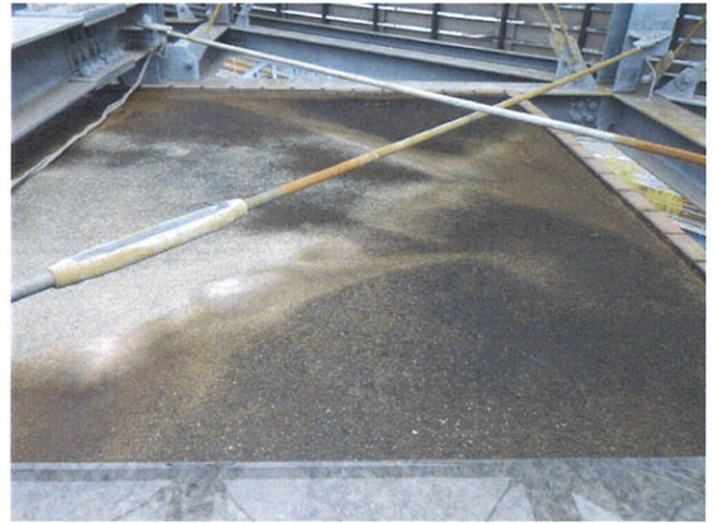
EVシャフト屋根 平場:表層の風化
