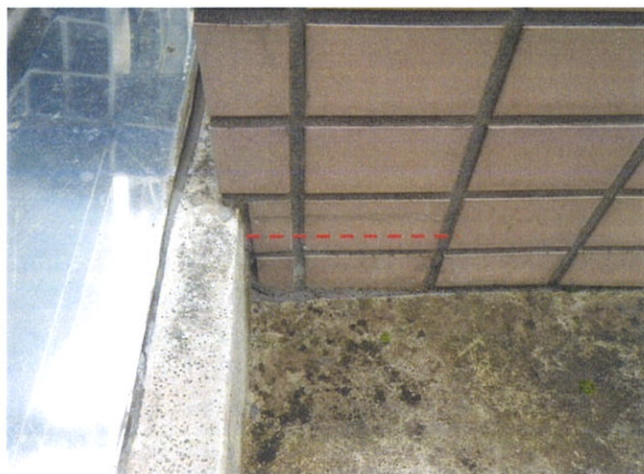
屋上 外壁:タイルのひび割れ
