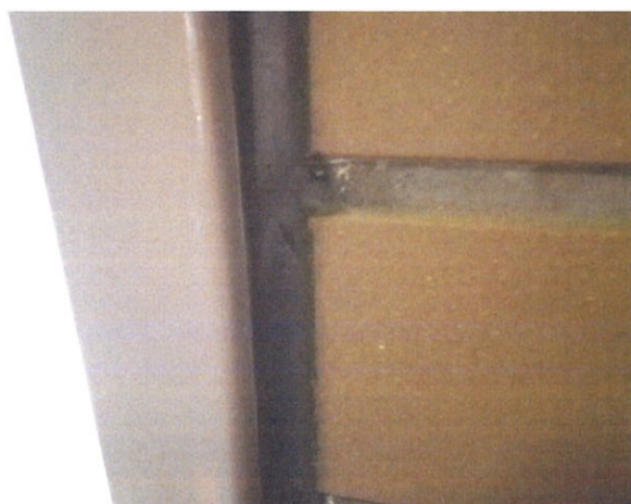
部 位：PS扉廻り目地 状 況：汚れ
