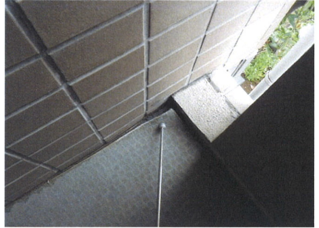
共用廊下 床面:シートの浮き
