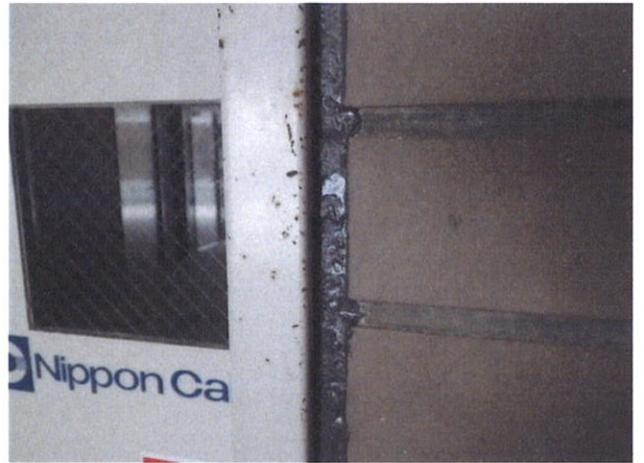
部 位: 鋼製扉廻り目地 状 況: 軟化現象
