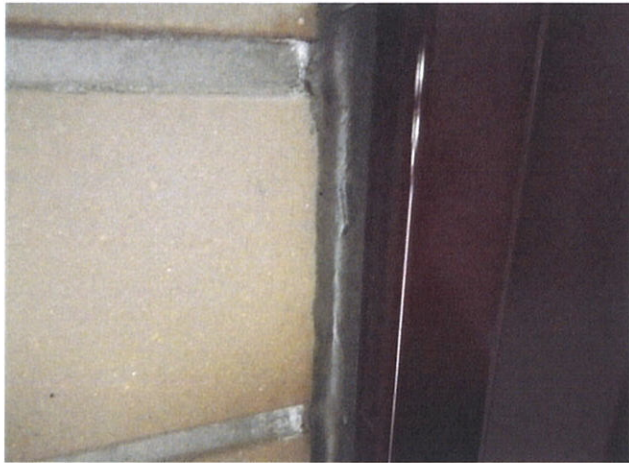
部 位: EV扉廻り目地 状 況: 汚れ
