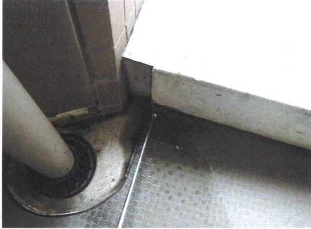
共用廊下 床面:シートの浮き
