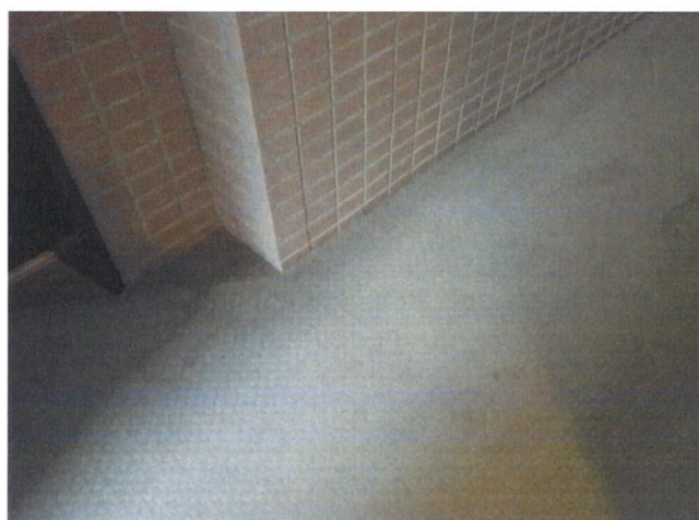
共用廊下 床面：経年による汚れ
