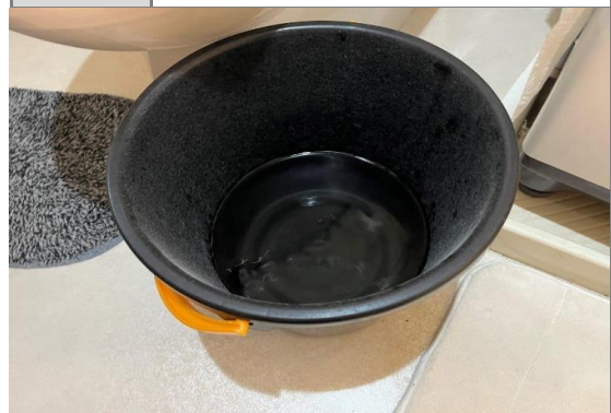
No.24 洗面脱衣所天井ダウンライト 周りから断続的に漏水
