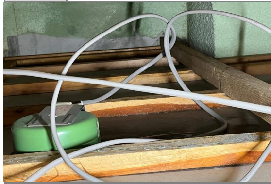
No.28 天井ボードが濡れています
