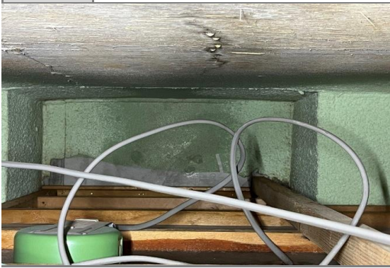
No.27 天井スラブに水滴が付着しています
