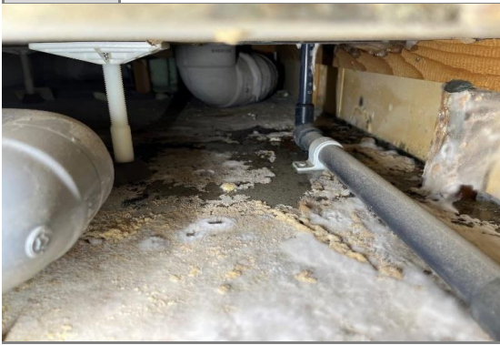
No.19 水面に白いカビが発生しています
