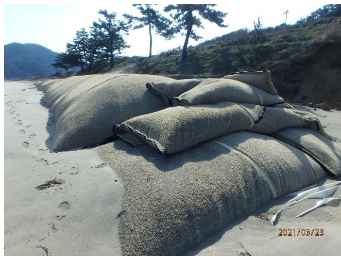
(R3.3.23 旧東浜小前浜のサンドバック(県施工))
