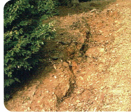
9 三河地震による地割れ (蒲郡市:市指定天然記念物) 1945年に発生した、三河湾を震源とする地震による地割れ。宗徳寺の裏に残っています。
